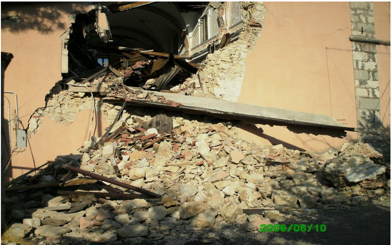
La stessa dopo il sisma
